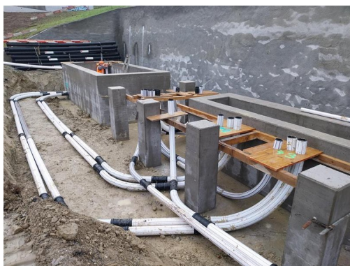
Verrohrung der Anlagekomponenten
